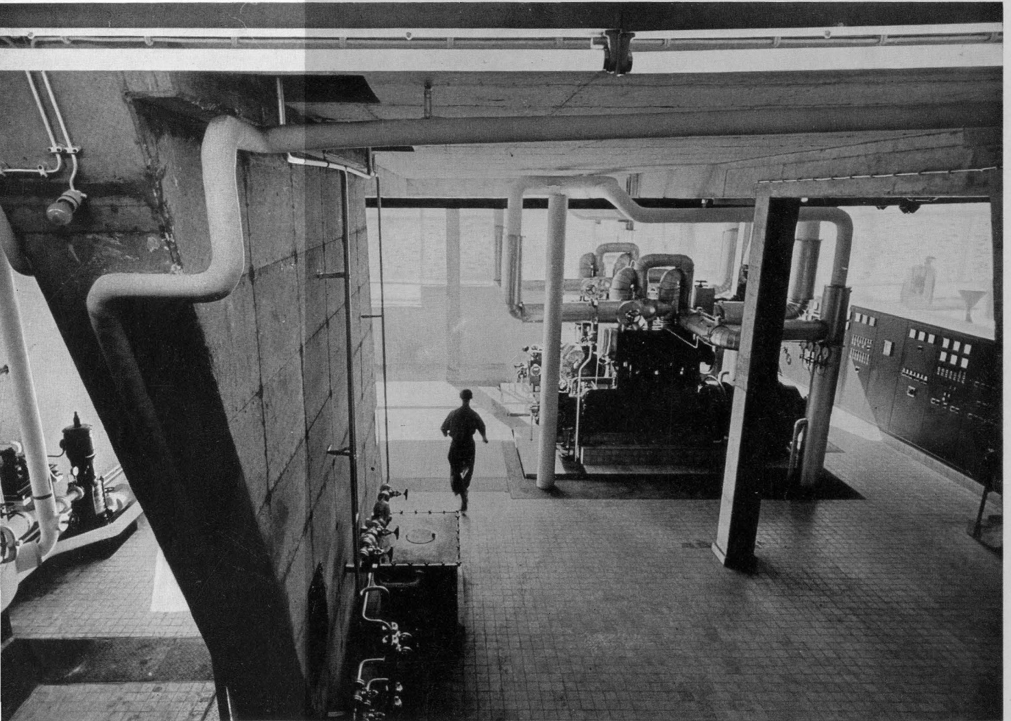
Heiz-Kraft-Zentrale im Berliner Corbusier-Hochhaus
